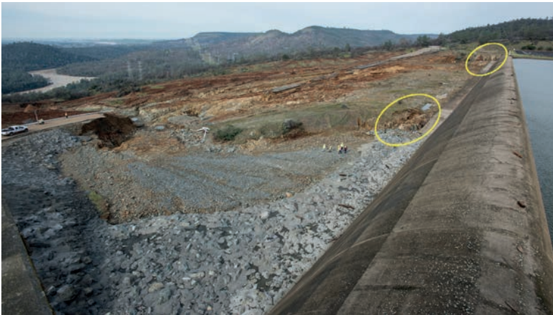
Abb. 4 Gravierende Erosion am Notfall-Überlauf (Markierung). Es besteht das Risiko einer Unterspülung und des Bruchs des Wehrs. Weiter unten: weggespülte Straße und Entstehung eines Abflusskanals. (Foto/Credit: Kelly M. Grow/California Department of Water Resources)
